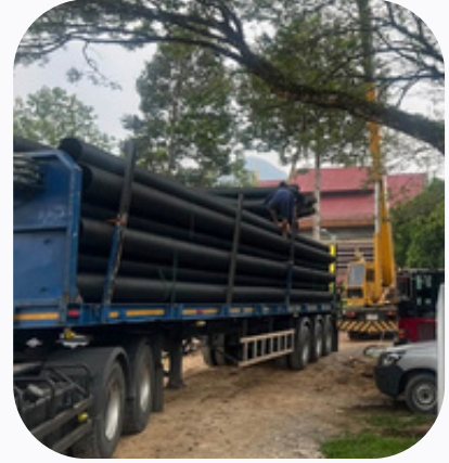
ระบบรวบรวมน้ำเสียราชภัฏนครศรีธรรมราช บริษัท เอเชียน เทค แอนด์ เอ็นจิเนียริง จำกัด
